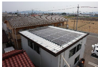
倉庫等に設置した太陽光パネル
